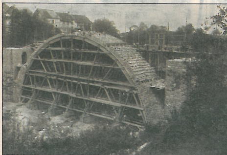
Le lavage de la voûte centrale a été effectué en octobre et novembre 1900.
